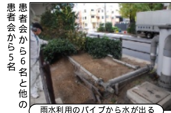
雨水利用のパイプから水が出る
